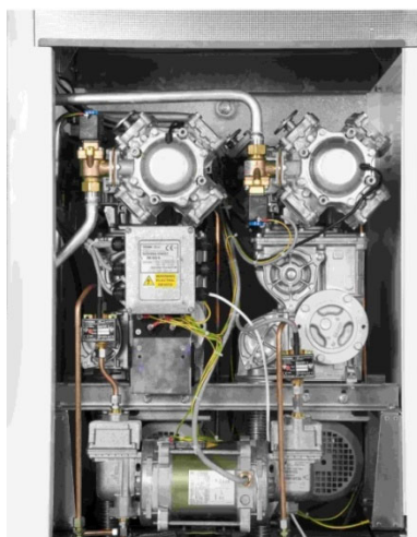
Abbildung 93 - Abgedeckte Tanksäule, B-Seite
